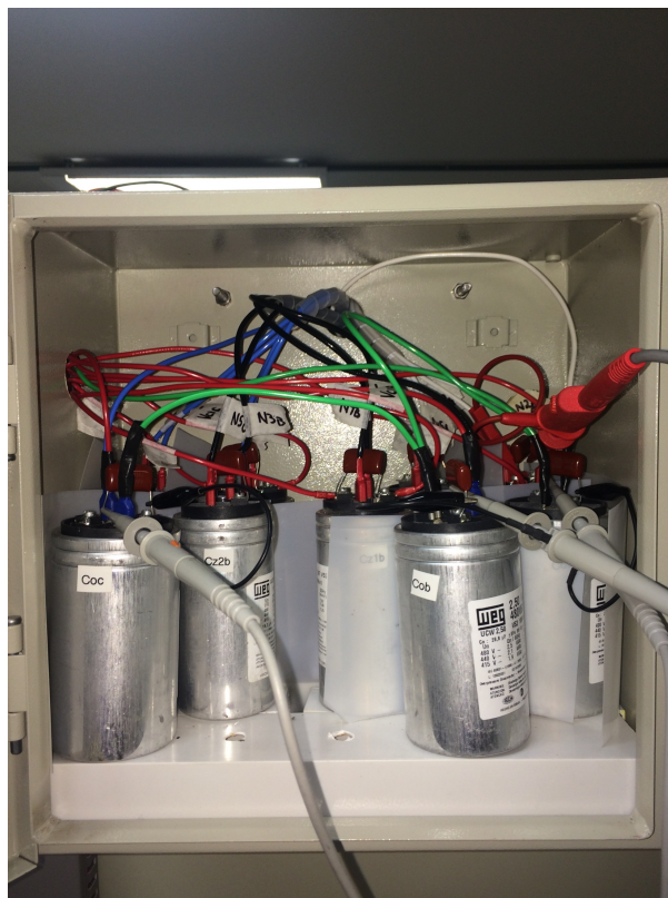
Figura 91 – Capacitores montados na parte de trás do Painel da Figura 89
