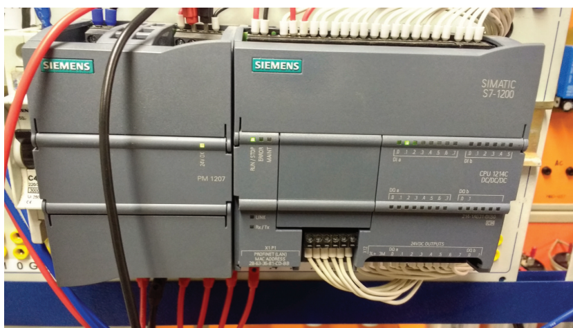
Figura 41 – Detalhe do CLP SIEMENS SIMATIC S7 - 1200.
