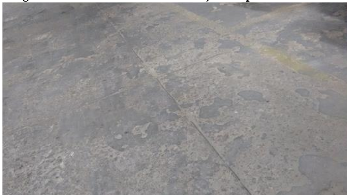
Figura 39 – Problema de delaminação em pisos de concreto.
