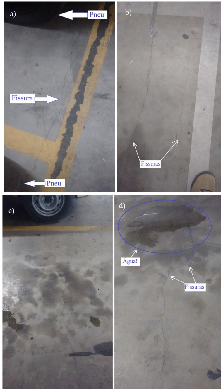
Figura 31– Problemas de fissuração por ação de cargas concentradas e suas consequências.
