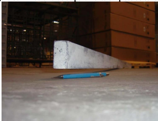
Figura 38 – Problema de empenamento em pisos de concreto.
