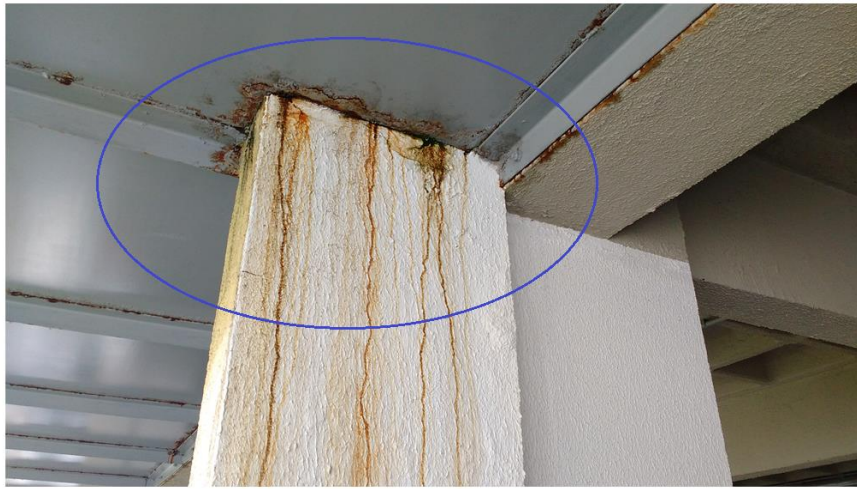
Figura 32 – Laje tipo steel deck com infiltração.
