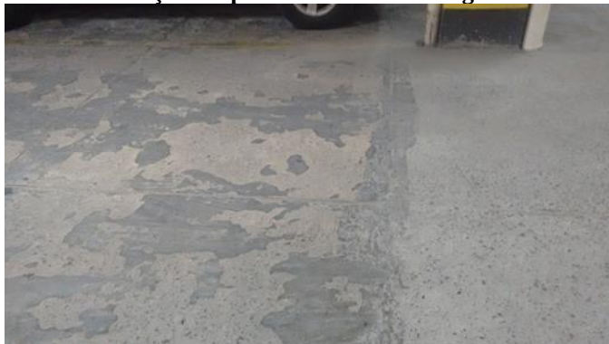
Figura 40 – Delaminação em pisos de concreto no Agreste Pernambucano.
