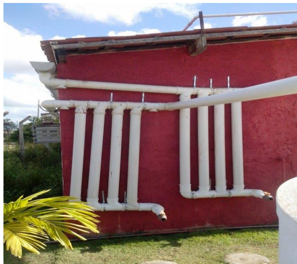
Figura 8: Sistema de desvio das primeiras águas de chuva instalado no Campus do Agreste da UFPE.
