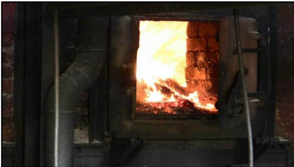
Figura 3.3 - Processo de queima do bagaço da cana-de-açúcar em caldeira.
