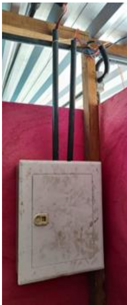
ENTRADA PROVISÓRIA DE ENERGIA ELÉTRICA AÉREA TRIFÁSICA 40A EM POSTE DE MADEIRA
