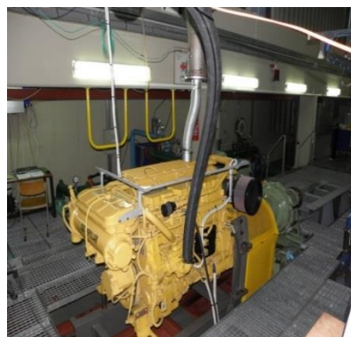
Figura 4 - Motor Caterpillar 3508 de 750 kW
