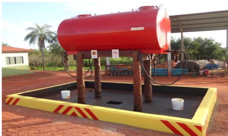
Figura 22- Tanque de armazenamento de óleo diesel com bacia de contenção
