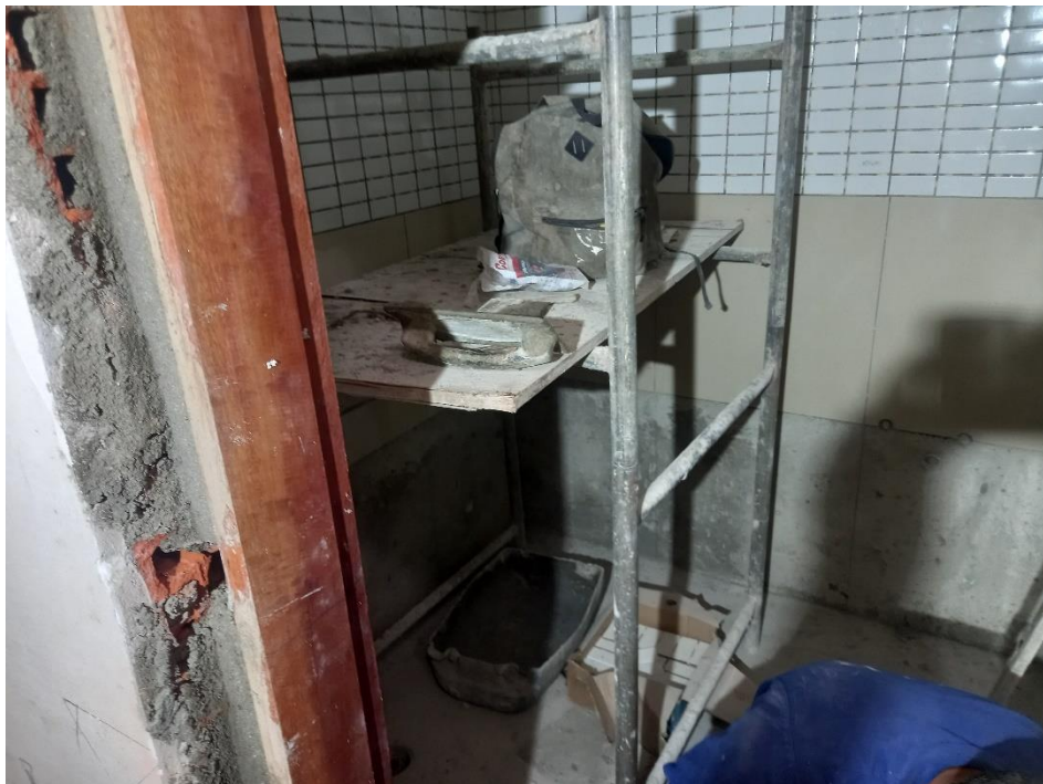
Figura 4 – Revestimento dos banheiros.
