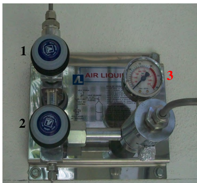
Figura 2. Central de gases Air Liquide. Os números representam: válvula de purga (1), válvula da central (2) e manômetro de alta pressão (3). Foto: Jéssica Moura.
